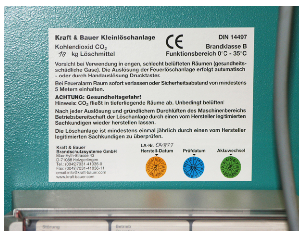
Beispiel: Prüfplaketten Fa. Kraft & Bauer
